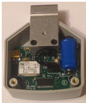
Figur 10. Udskiftning af batteri
